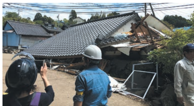
熊本地震の家屋倒壊調査(H28.04.26)
