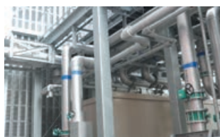
排熱利用吸収式冷凍機
