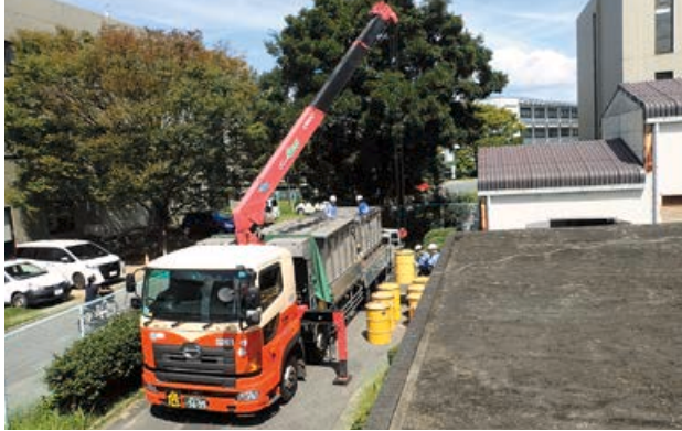
高濃度PCB廃棄物搬出状況(H29.09.13)
