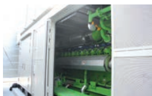
ガスコージェネレーション
