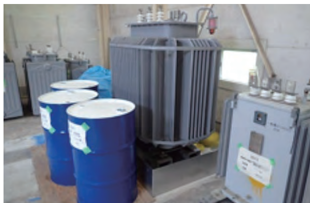
抜油(ドラム缶)と漏洩防止装置(H29.03.31)
