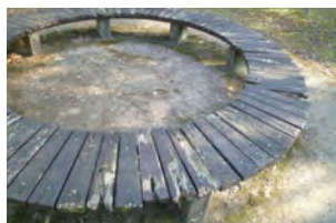
修繕前のベンチ (H27.01.07)
