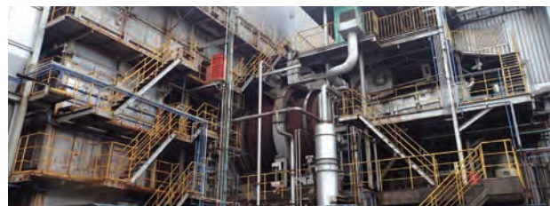
委託先処理施設の焼却炉(H28.10.28)
