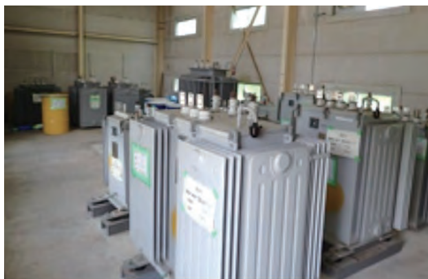
低濃度PCB廃棄物保管状況(H29.03.31)
