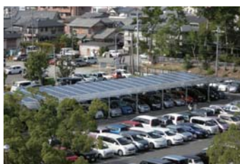
カーポート型太陽光発電設備
