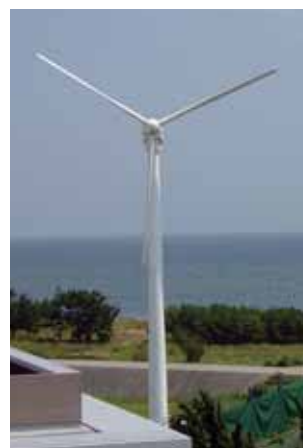
風力発電実験装置
