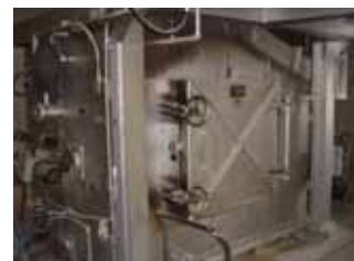
動物実験施設1階焼却室
