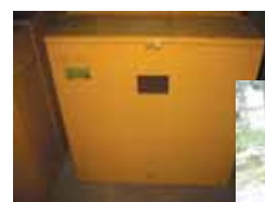
高圧コンデンサ保管状況 (密閉容器)
