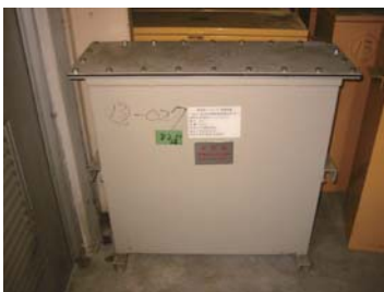
高圧コンデンサ保管状況
