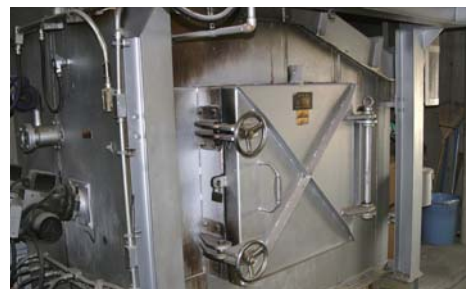
動物実験施設の焼却炉
