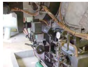
生物資源学部ボイラー室
