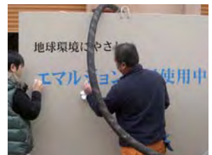
エマルジョン燃料タンク設置状況
