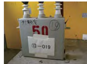
点検のため容器から出された 高圧コンデンサ
