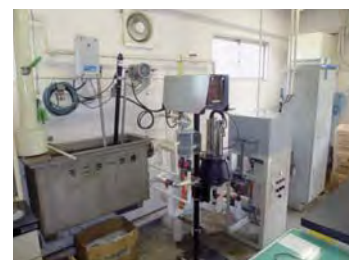
排水処理施設水質分析装置
