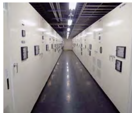
病棟・診療棟4階電気室
