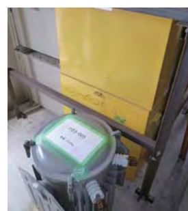
高圧コンデンサ・変圧器
