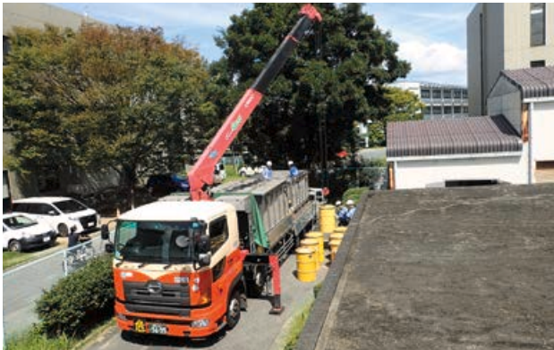
高濃度PCB廃棄物搬出状況(H29.09.13)
