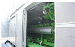
ガスコージェネレーション
