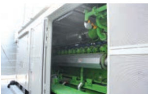
ガスコージェネレーション
