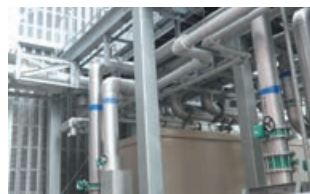
排熱利用吸収式冷凍機
