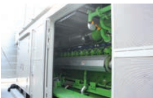
ガスコージェネレーション
