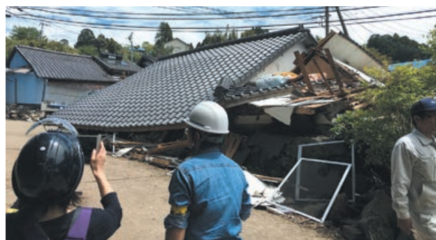
熊本地震の家屋倒壊調査(H28.04.26)
