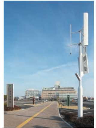
ハイブリッド(風車+太陽光パネル) LED照明(H30.03.06)
