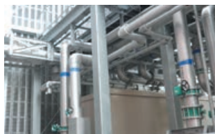
排熱利用吸収式冷凍機
