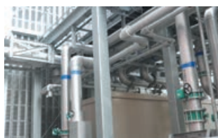
排熱利用吸収式冷凍機
