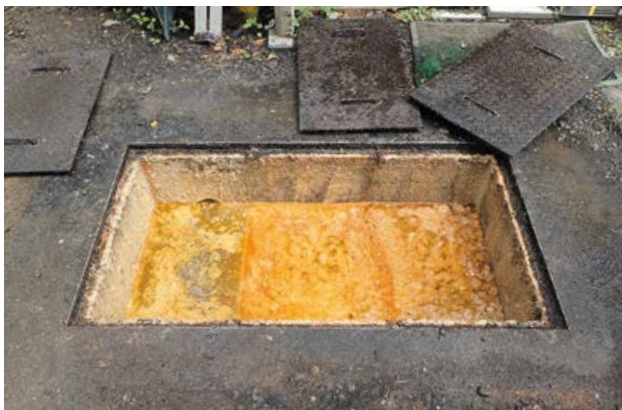
改修前のグリーストラップ(H29.06.26)
