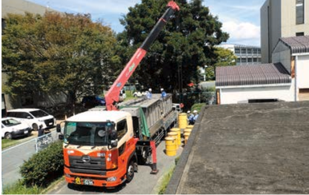
高濃度PCB廃棄物搬出状況(H29.09.13)
