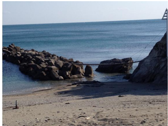
図 地上に表れている海底ケーブル
